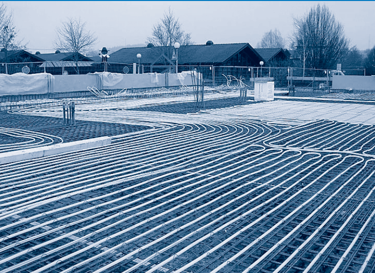
Foto: Dr. Simone Walker Hertkorn, Systherma-Planungsbüro für Erdwärmesysteme
